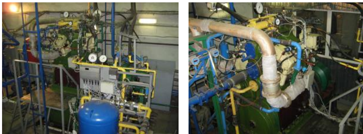
Рис. 2. Вид на отсек ЧН26/26
