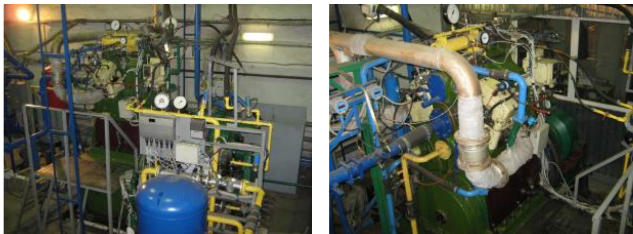
Рис. 2. Вид на отсек ЧН26/26
